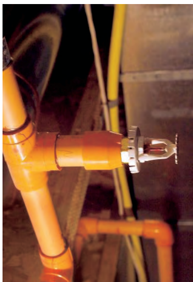
Impianto a pioggia (sprinkler)
